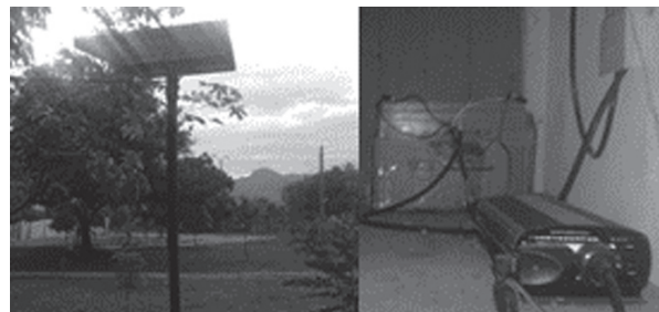
FIGURA 17. Panel solar, batería eléctrica seca y regulador de voltaje.
